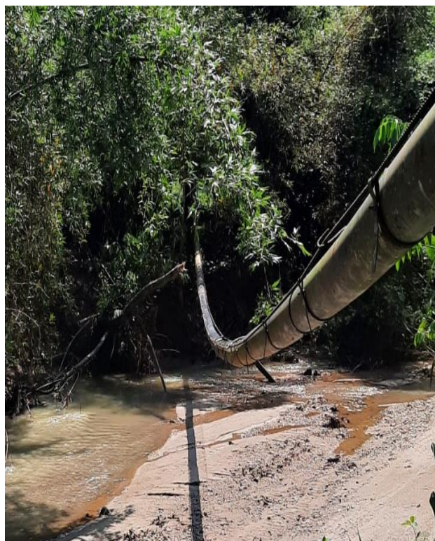
Mal estado del viaducto de Maquenque
