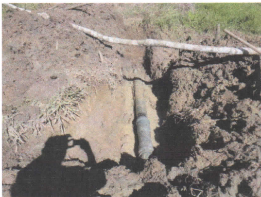
Daños ocasionados en el jarillón
